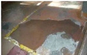
床仕上げの剥がれ
