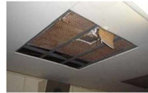
天井材の落下・剥がれ
