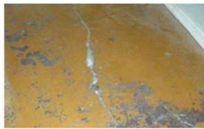
床のひび割れ
