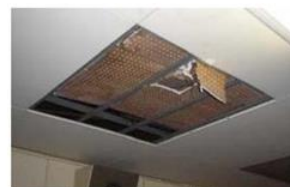
天井材の落下・剥がれ
