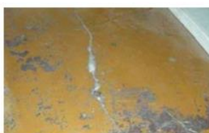
床のひび割れ
