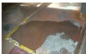
床仕上げの剥がれ
