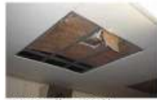
天井材の落下・剥がれ
