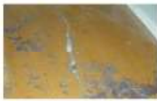
床のひび割れ
