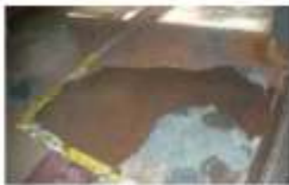
床仕上げの剥がれ
