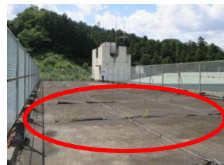
屋根・屋上の損傷（武蔵台中学校）
