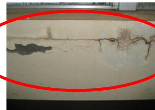
内壁の損傷（高麗中学校体育館）
