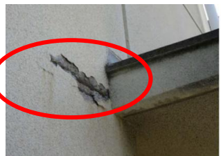
外壁の損傷（高根中学校）
