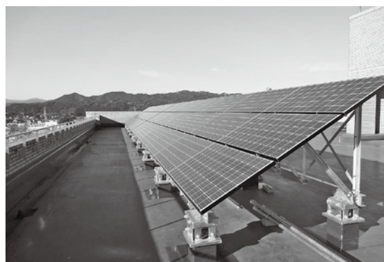
〈市役所屋上の太陽光パネル〉
