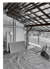
10年以上屋根の破損
