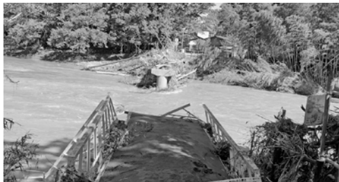
増水で倒壊した新井橋
