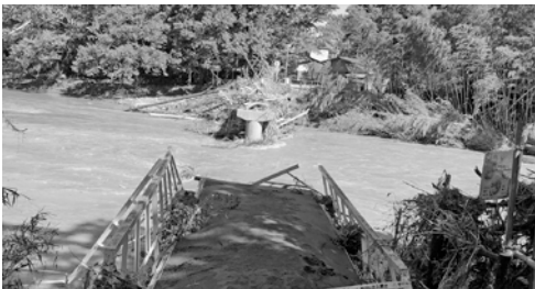
増水で倒壊した新井橋
