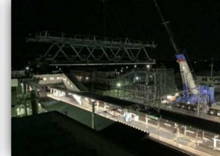
自由通路の主要部材となるトラス梁構造の桁の架設状況(令和7年5月)
