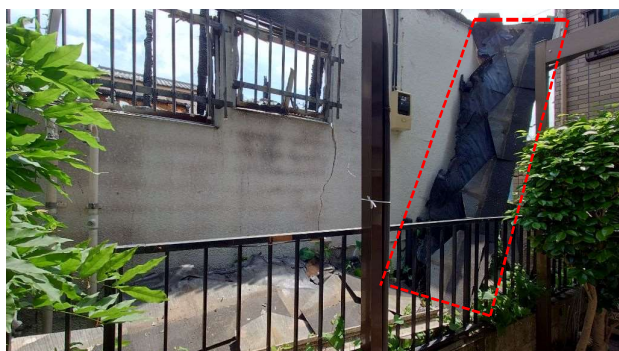
緊急安全措置実施前 R6.5.21 ↑
