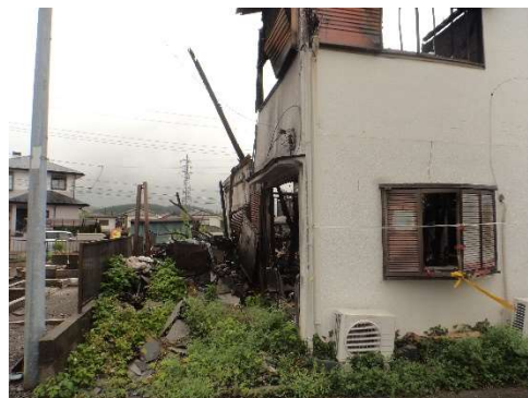
庭にも残置物が堆積している。
