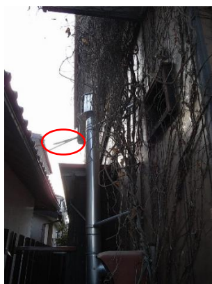
木材が飛び出している。
