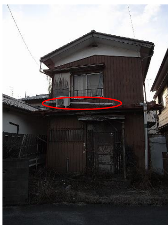
臭気管が外れ倒れている。
