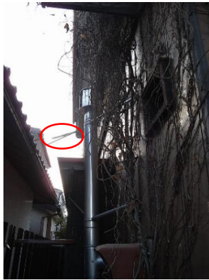
木材が飛び出している。
