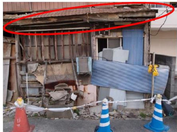
軒に不陸、剥離が生じている
