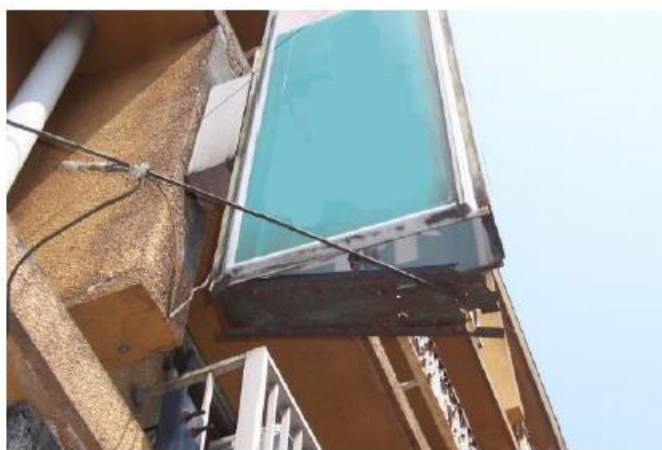
底板に腐食が発生している
