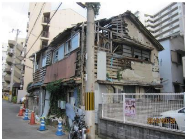
外壁の脱落、屋根ふき材の脱落等
