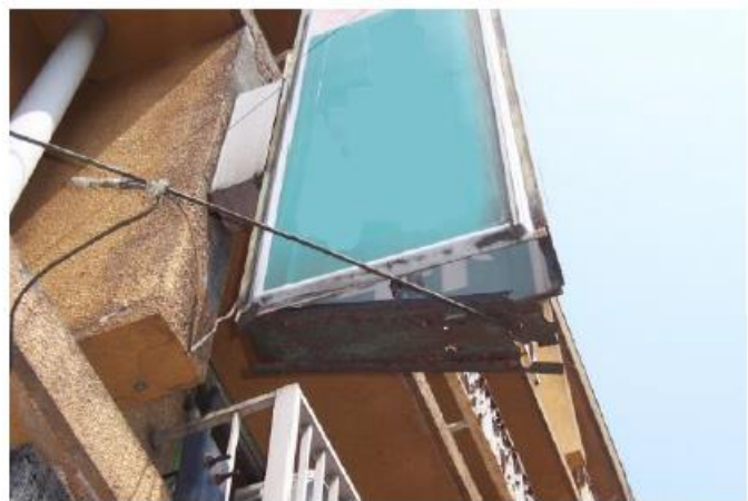
底板に腐食が発生している
