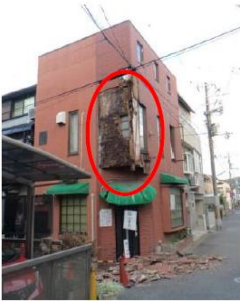
外壁が破損している
