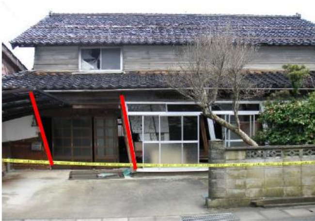
1階部分が傾斜している
