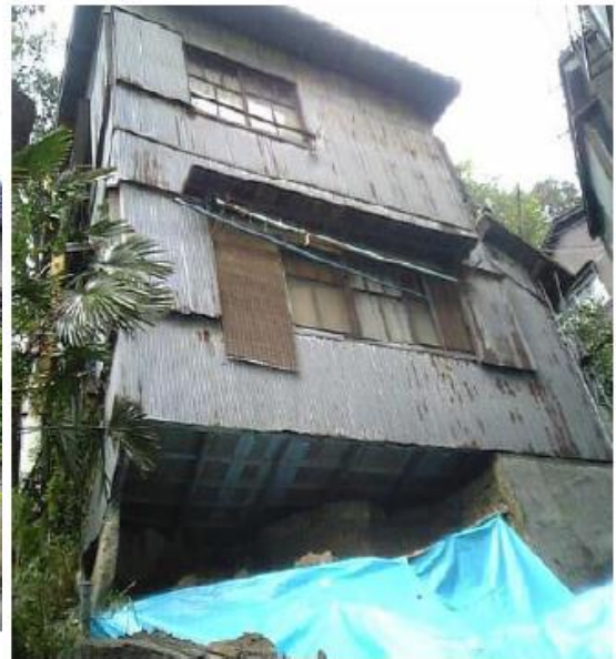
基礎が大きく欠損している
