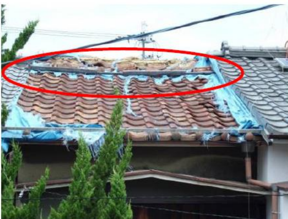
屋根ふき材に剥離、脱落が生じている
