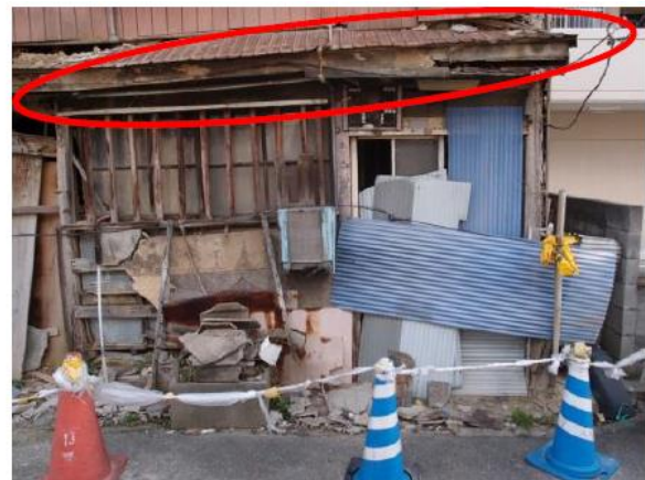
軒に不陸、剥離が生じている
