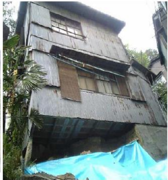
基礎が大きく欠損している
