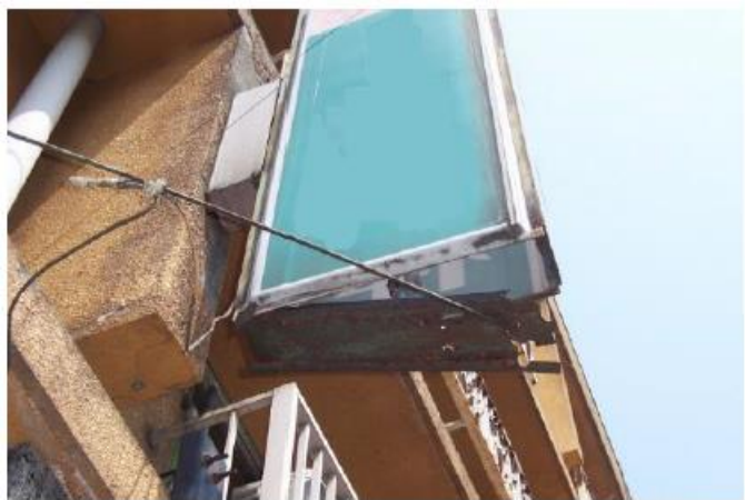
底板に腐食が発生している
