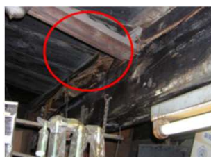
②はりの破損、腐食
