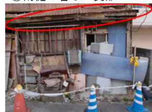
⑤軒に不陸、剥離
