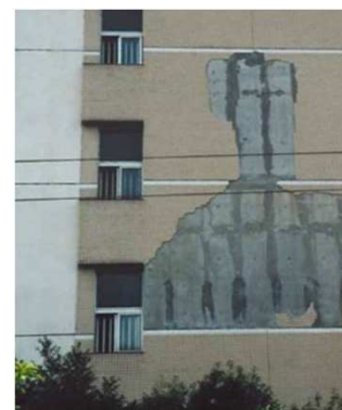
③外壁が剥落
