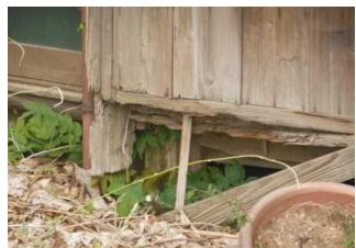
⑥基礎の破損
