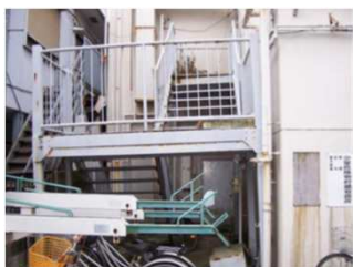
①屋外階段が傾斜
