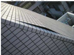
④外壁に浮き発生
