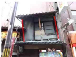
②2階沈み込み、傾斜
