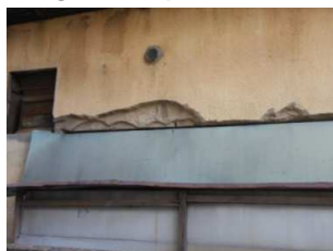
⑥外壁の剥落、破損
