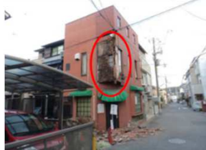
②外壁が破損
