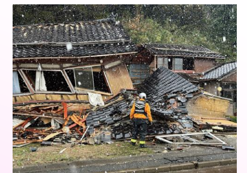
【能登半島地震による建物被害】
