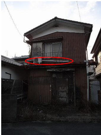
臭気管が外れ倒れている。
