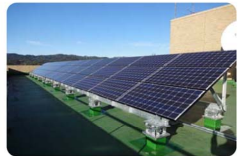
市役所屋上の太陽光パネル
