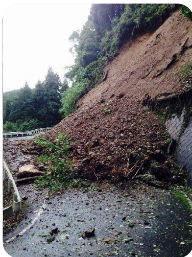
土砂崩れによる被害の様子
