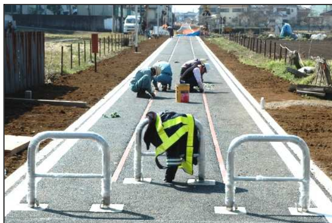
開通に向け、工事が進む旧太平洋セメント側線敷き用地（2月23日撮影）
